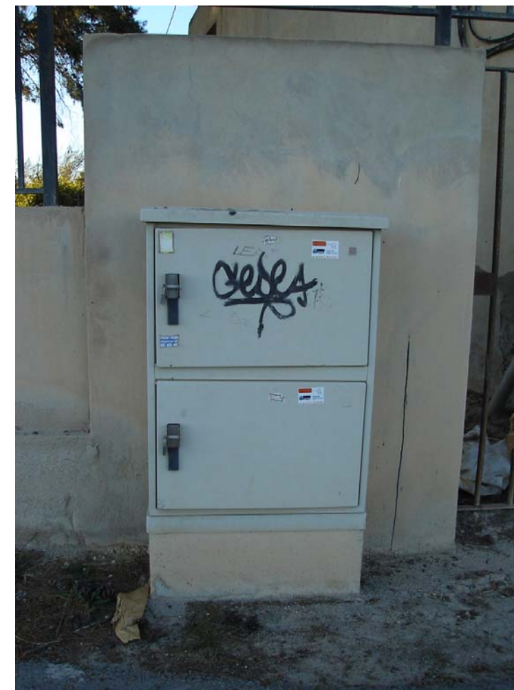
CENTRO DE MANDO DE ALUMBRADO EXISTENTE A SUSTITUIR PK 0+735
