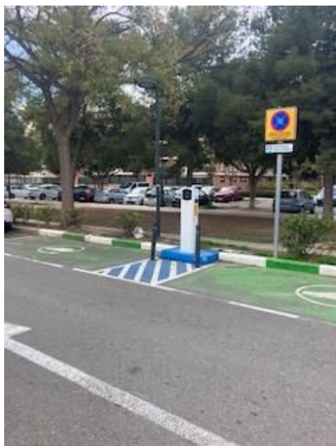
PUNTO DE RECARGA 1 C/ BARCELONA Nº2
