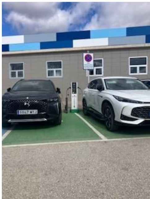
PUNTO DE RECARGA 1
